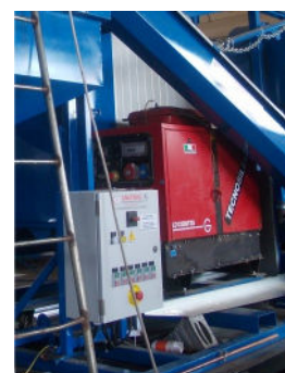
Predisposizione spazio per alloggiamento eventuale gruppo elettrogeno
