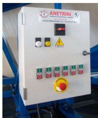
Quadro elettrico di comando con sistema controllo terra
